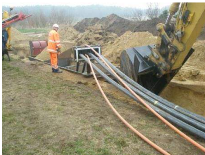
Mynd 3.5. Jarðstrengur lagðir með aðstoð grafrarkassa í dönsku strengverkefni. Hér eru strengir lagðir í skurð í kjölfar graftar [8].
