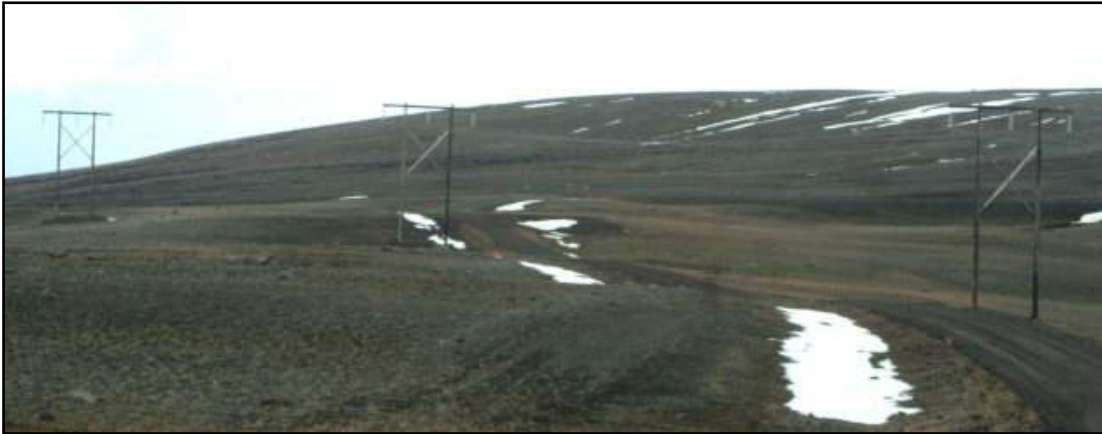
Kröflulína 2 fer yfir Brúarveg (F907) við Þrívöðuháls, skammt frá Sænavatni, rétt við gatnamótin að Möðrudalsvegi (901). Línan fer þarna einnig yfir Möðrudalsveg, örlitlu norðar.
