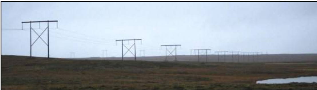
Kröflulína 2 á Fljótsdalsheiði. Þarna er lína byggð sem 220 kV. Fjær sést 220 kV stálmastrakafli.
