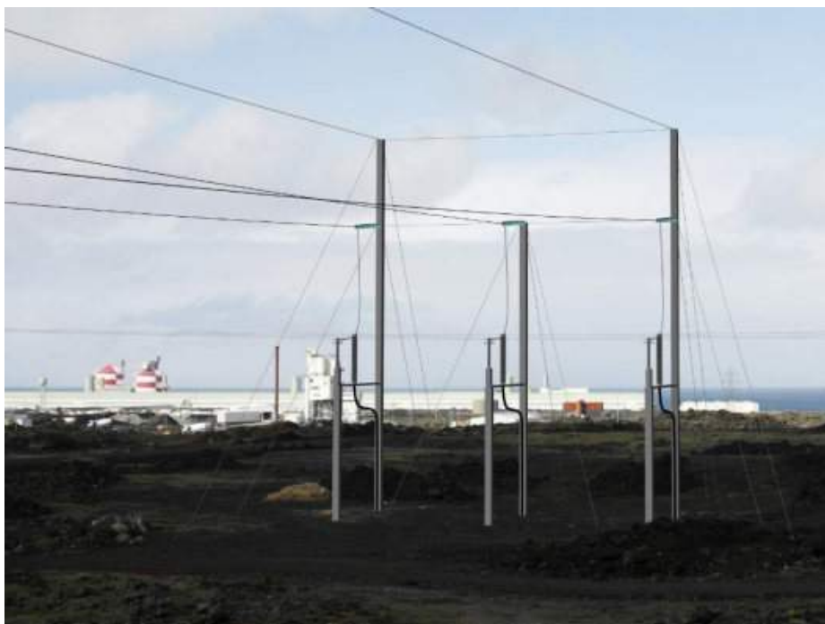
Mynd 4.6. Möguleg tenging á einu setti jarðstrengja við loftlínu í strengendamastri. Jarðstrengur kemur upp á súlum sem tengjast mastri. Svæðið er ekki afgirt.
